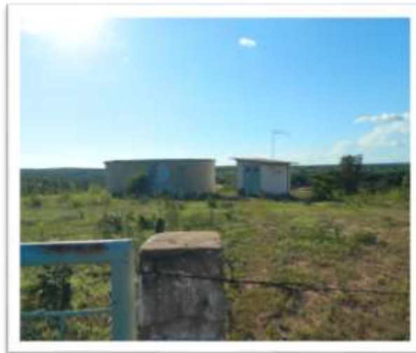
Figura 34: Reservatório Semi Enterrado - RSE de distribuição de água e a Casa de Armazenamento do produto químico.
