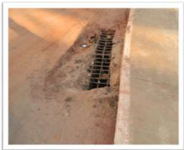
Figura 43: Boca-de-lobo obstruída por falta de limpeza urbana.
