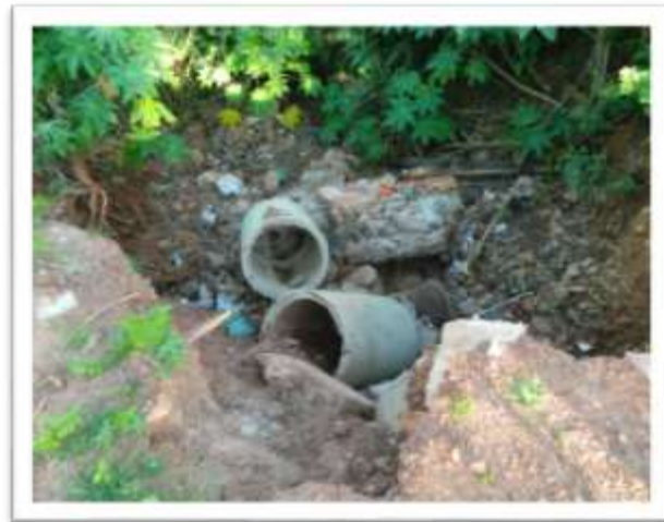
Figura 44: Sistema de drenagem destruído por problema de erosão.
