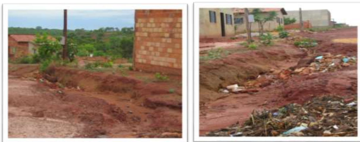
Figura 26: a) e b) Ruas do Setor Sul com problema de erosão evidente.
